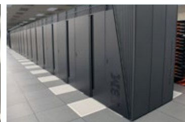
° Centro de transformación de energía
