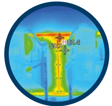
Resultado de la termografía en los CLIBOS-TR con el horno en funcionamiento
