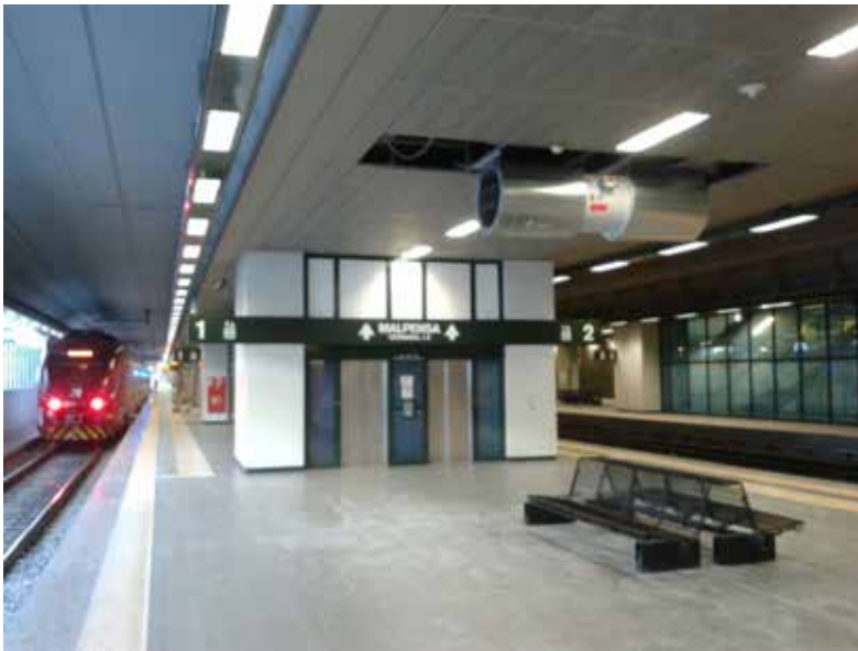
Jet fan en estación subterránea del aeropuerto de Malpensa JFC
