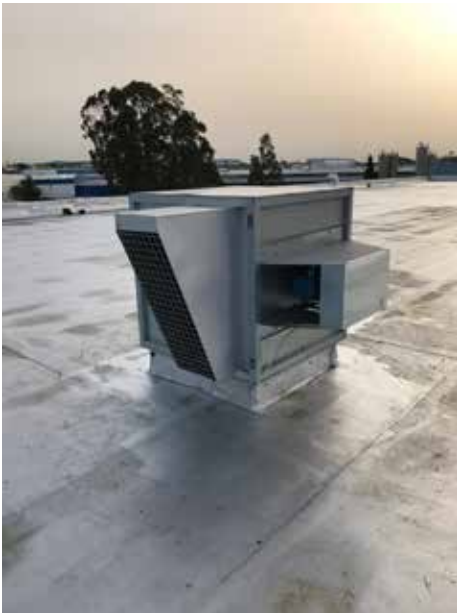
Extracción de humos en cocina de restaurante (Portugal) DHUMAT
