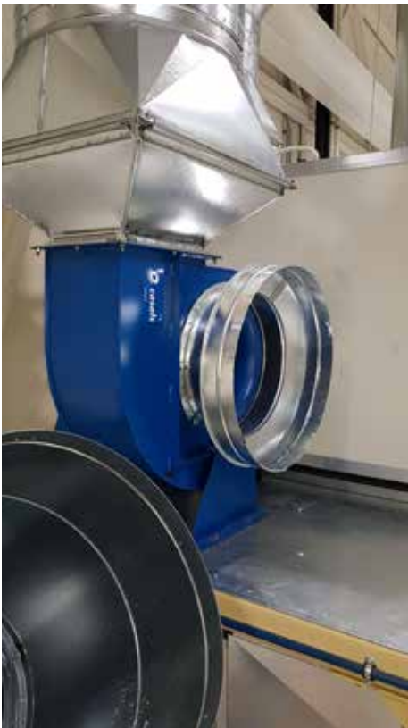
Extracción de media presión en fábrica automoción con ambiente ATEX MBX
